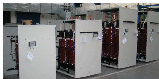
Трансформаторы в корпусах IP20 с выведенными шинами НН сверху трансформатора к шинным мостам.
