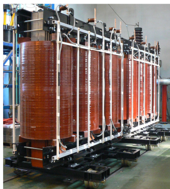
Трансформаторы 8000 кВА с соотношением 20/6 кВ
