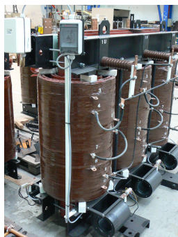
Трансформатор 630кВА с соотношением 15/0,4кВ с системой охлаждения АФ
