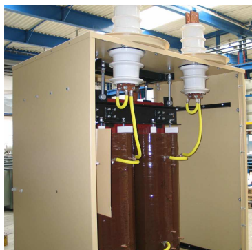
Трансформатор однофазный для возбуждения генератора 1350кВА напряжением 22 кВ
